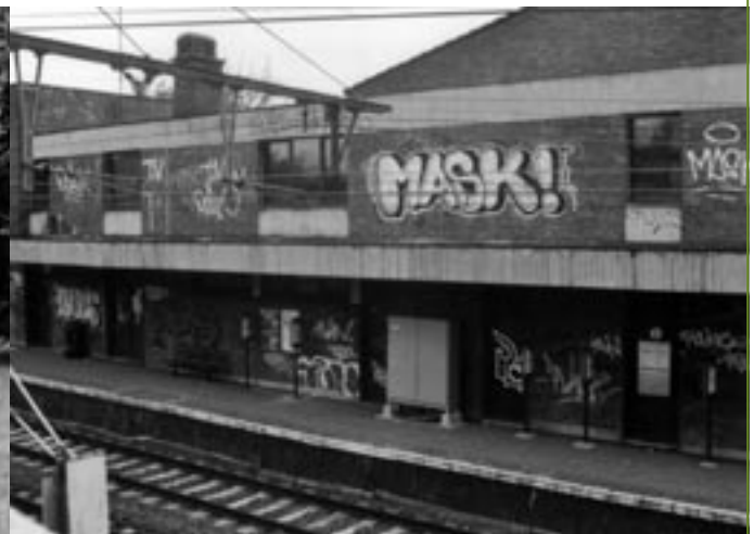
Graffiti is een echte plaag. Hier op het stationsgebouw van Linkebeek.
